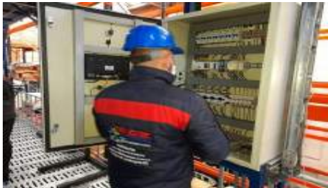
AUTOMATIZACIÓN Y CONTROL
