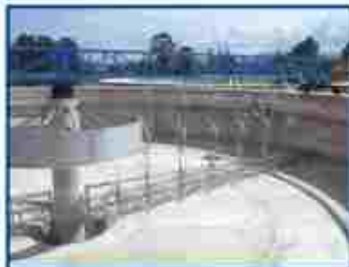
Clarificadores primarios/ secundarios con puentes barredores cilíndricos
