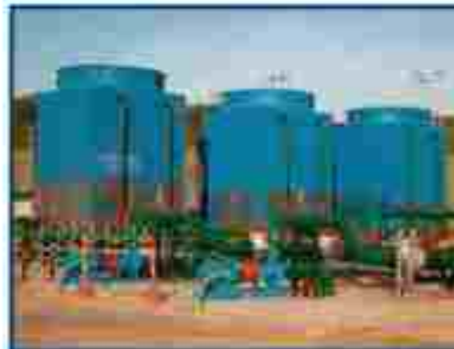
Torres de enfriamiento para aguas residuales
