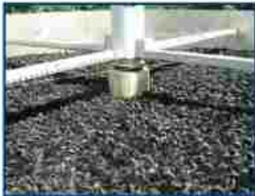
Filtros percoladores (biofiltros)
