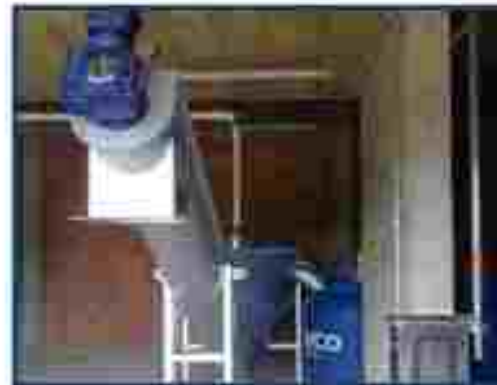
Tornillos deshidratadores de lodos
