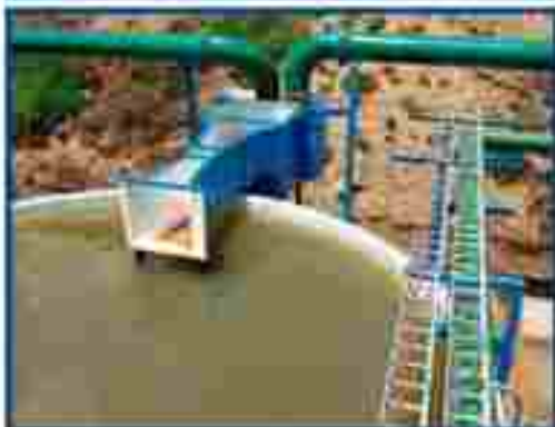
Canaletas parshall y vertederos
