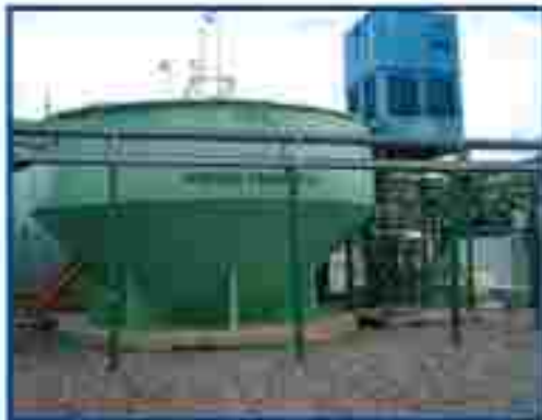
Clarificadores de manto de lodos para potabilización
