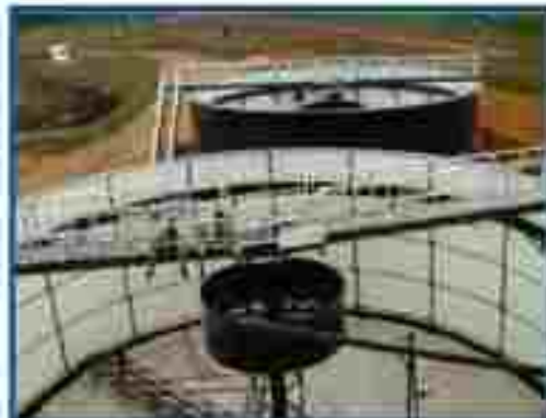
Clarificadores primarios/ secundarios con puentes barredores cilíndricos
