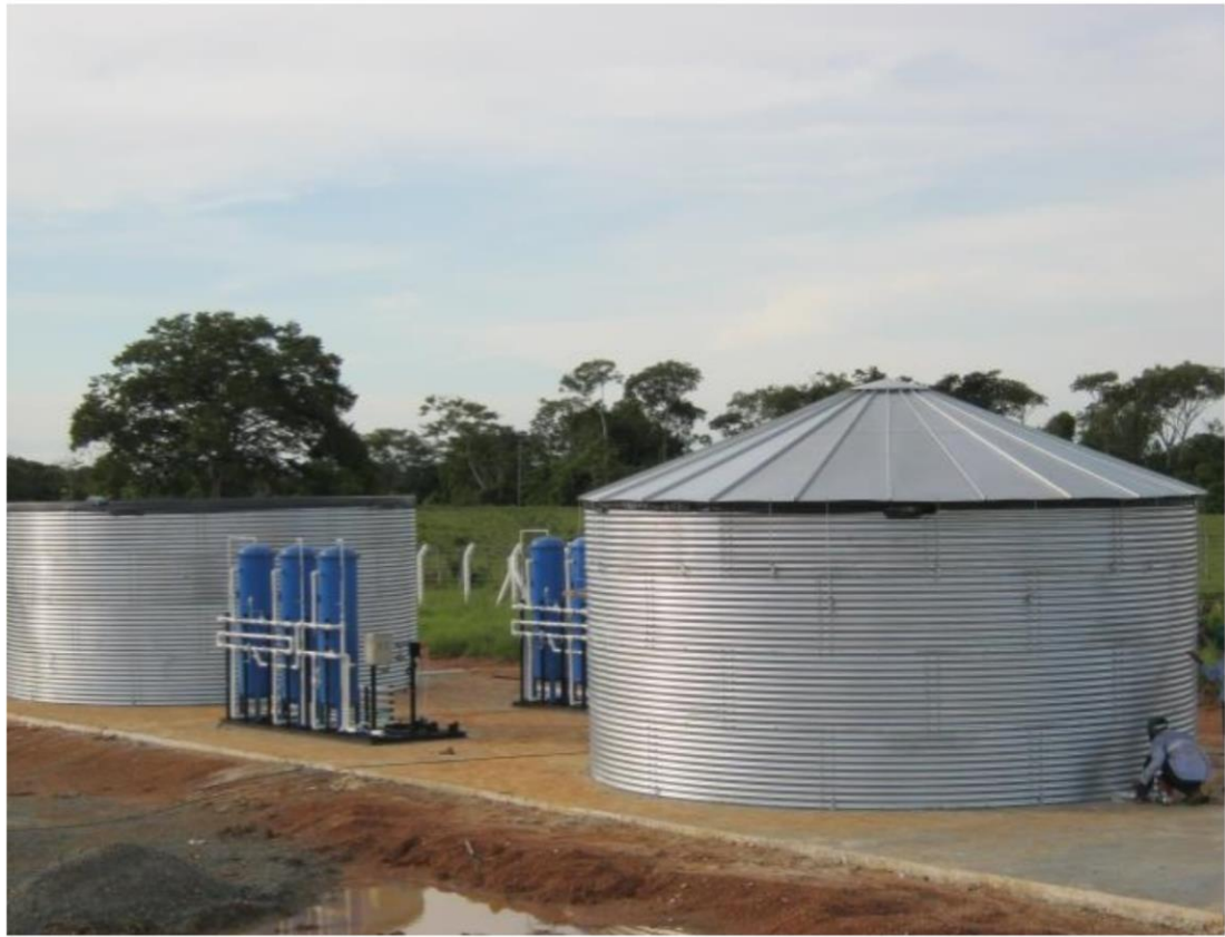
Acueductos rurales (Tanques para almacenamiento de agua potable)
