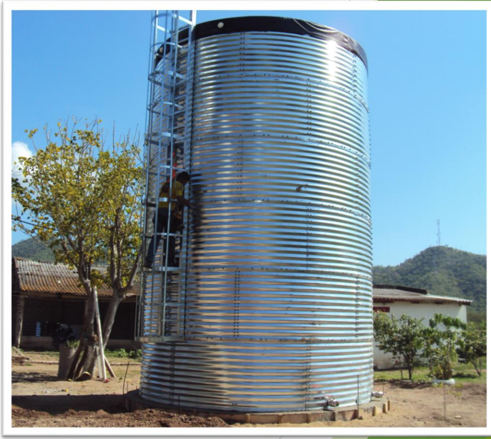
Hidrosilos (Almacenamiento agua y conducción a cero costo energético)
