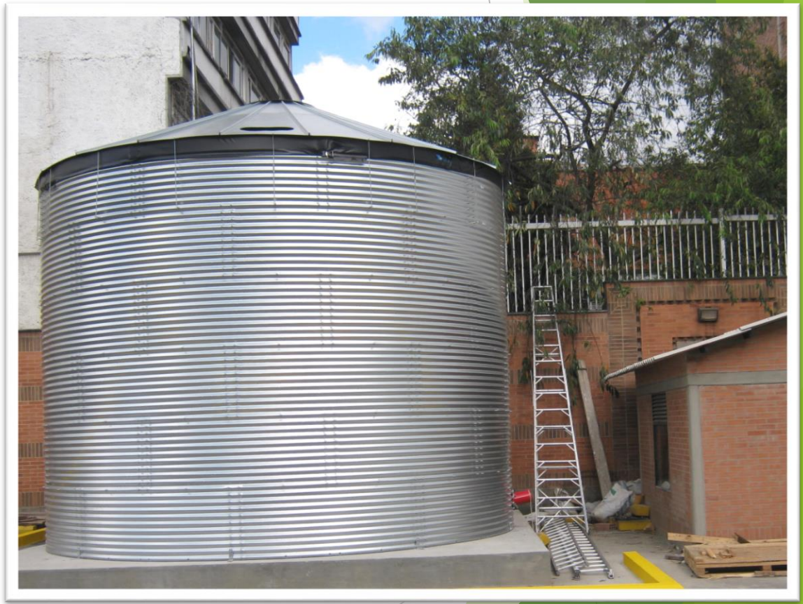
Tanques para almacenamiento de agua para redes contraincendios.
