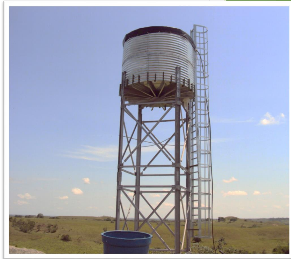
Tanques elevados (Almacenamiento agua y conducción a cero costo energético)
