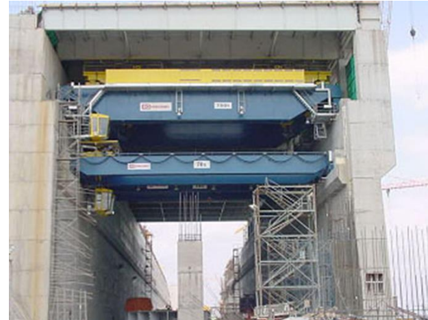
Hidroeléctricas (Caruachi , Venezuela - 790 Ton)
