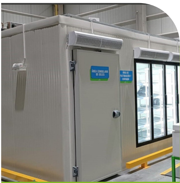
Cámaras de maduración de frutas y verduras
