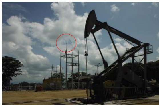
Pararrayos PDCE - DDCE instalado en pozo Santa Lucía Petronorte SAN ALBERTO – CESAR
