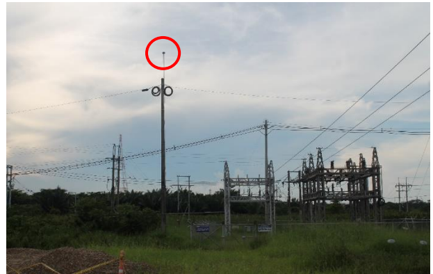
PDCE-DDCE instalado en ECOPETROL – Subestación Pórtico Galán Campo Casabe, Yondó, Antioquia
