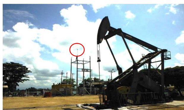
PDCE-DDCE instalado en Petronorte – Pozo Santa Lucía, San Alberto – Cesar.
