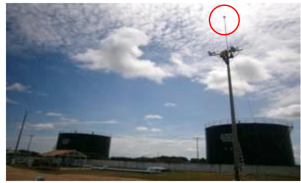
PDCE-DDCE instalado en CEPCOLSA - estación de bombeo – Maní. Casanare
