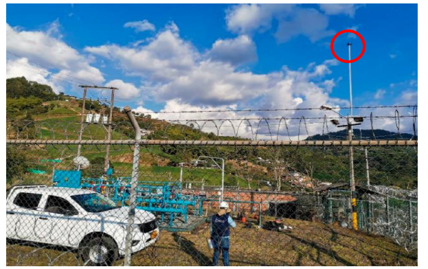
PDCE-DDCE instalado en TGI – Transportadora de Gas Internacional City Gate – Distrito 7 Dos Quebradas - Risaralda
