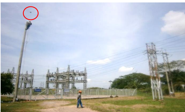
PDCE-DDCE instalado en ECOPELROL – Pórtico Galán – Barrancabermeja – Santander.
