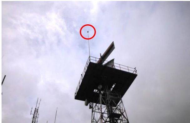
PDCE-DDCE instalado en AEROCIVIL Cerro Verde, Rionegro – Antioquia
