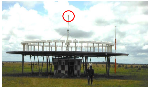
PDCE-DDCE instalado en VOR FUERZA AEREA COLOMBIANA GRUPO AERERO DEL ORIENTE (GAORI) Marandúa, Vichada – Colombia
