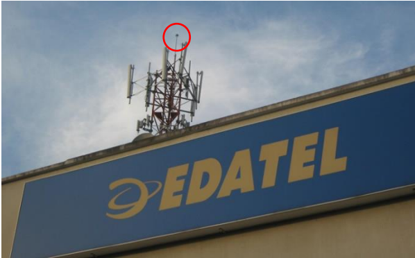
PDCE-DDCE instalado en EDATEL – Montería
