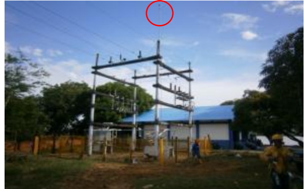
PDCE instalado en Aguas de Barrancabermeja
