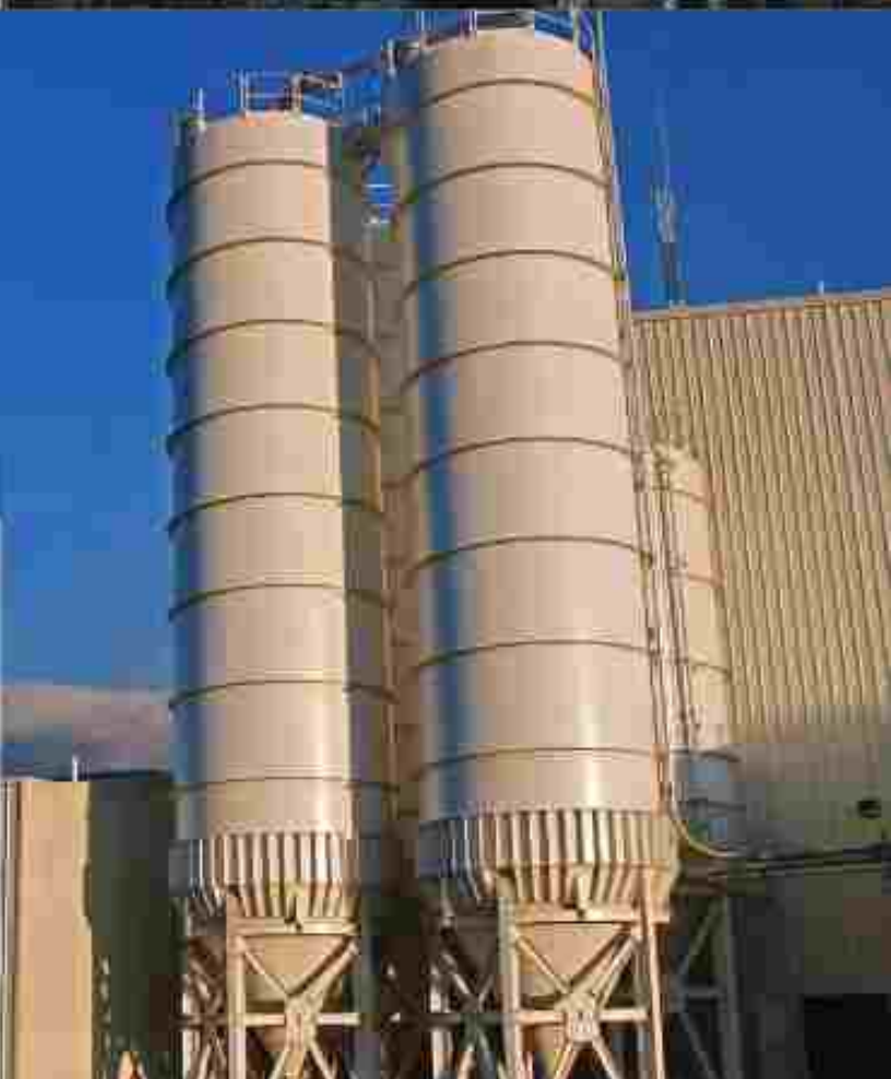
Instalación de planta de OGA para almacenamiento de PVC y CaCO 3 a través de líneas de transporte neumático de PVC. Flujo de proceso de 2 líneas.
