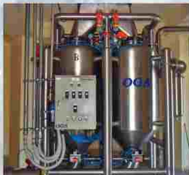
Sistema para dosificación continua instalado en Silo para refinación de azúcar. Flujo 70 ton/h
